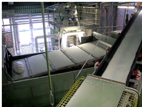
Die Inbetriebnahme der Siebanlage 2 erfolgte pünktlich am 27. Februar.
