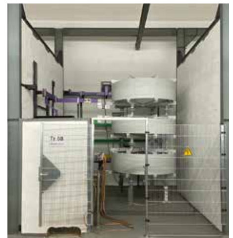
Eine der erneuerten Kurzschlussstrombegrenzungsdrosseln in der Station 60.
